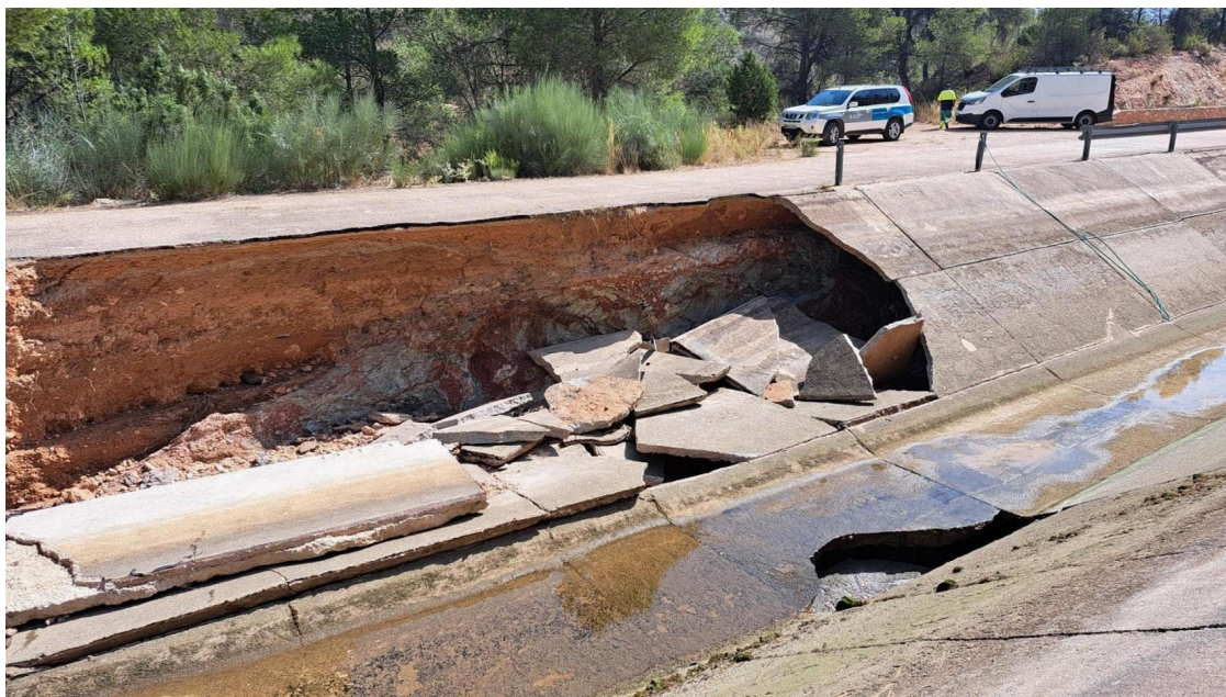
Rotura del acueducto del trasvase Tajo-Segura.
